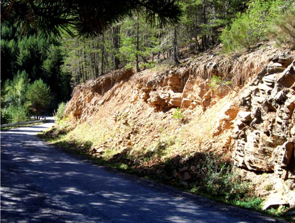
Talús en l'accés a l'estació d'esquí nòrdic de Sant Joan de l'Erm
