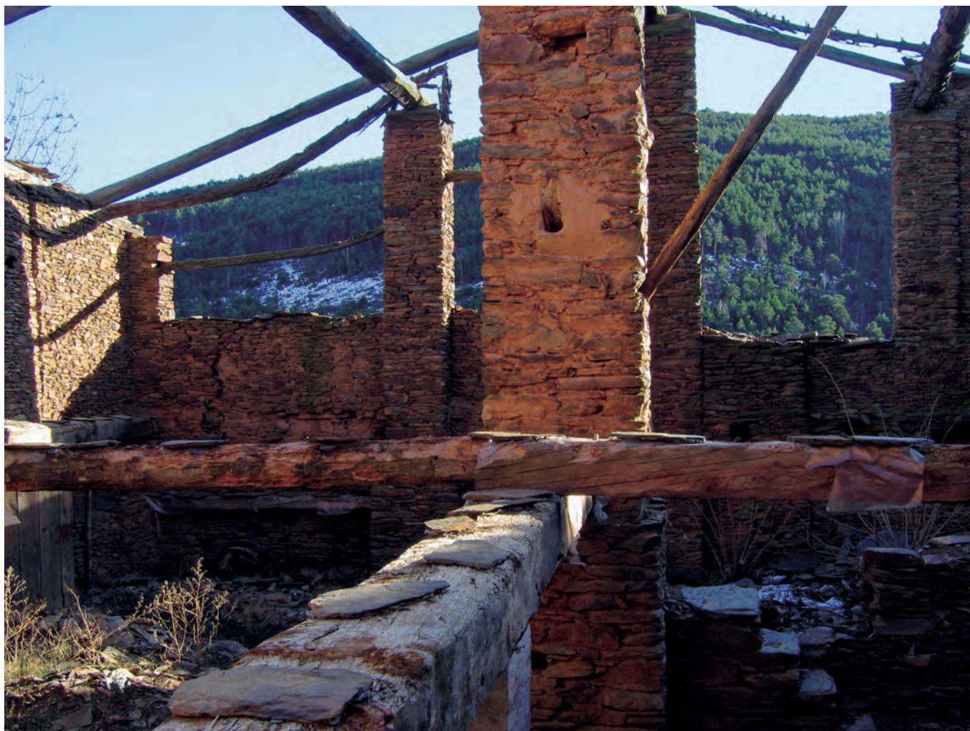
Casa abandonada, a Sant Andreu. No és per avergonyir-se el deteriorament, arreu, del nostra imponent patrimoni rural?
